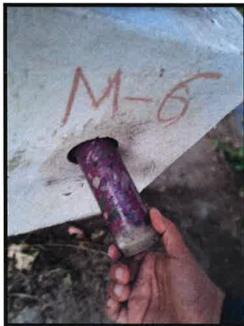
Fig. 03 – Carbonatación Muestra M-6
