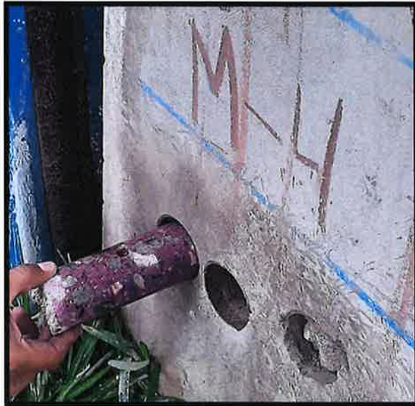
Fig. 02 – Carbonatación Muestra M-4
